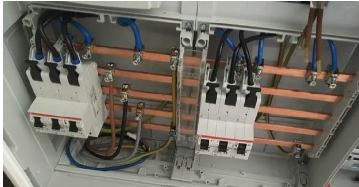
Grössere Stromschielen für 22 kW Sonnencharger (Wallbox)
