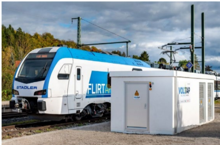
Schnellladestation „VOLTAP“ der Furrer + Frey AG und den Stadtwerken Tübingen
